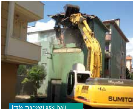
Trafo merkezi eski hali
