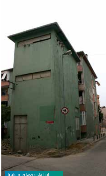
Trafo merkezi eski hali
