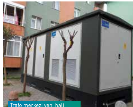
Trafo merkezi yeni hali
